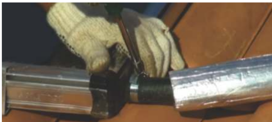
Isolamento térmico é afastado para fixação da abraçadeira junto ao coletor solar
