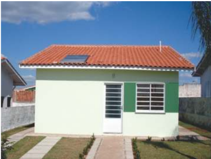
Sistema de aquecimento solar convencional instalado em HIS
