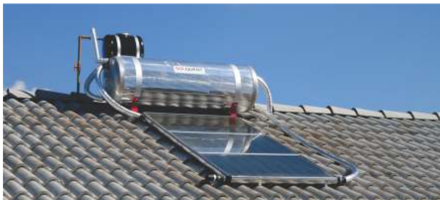
Aquecedor Solar Compacto sobre o telhado
