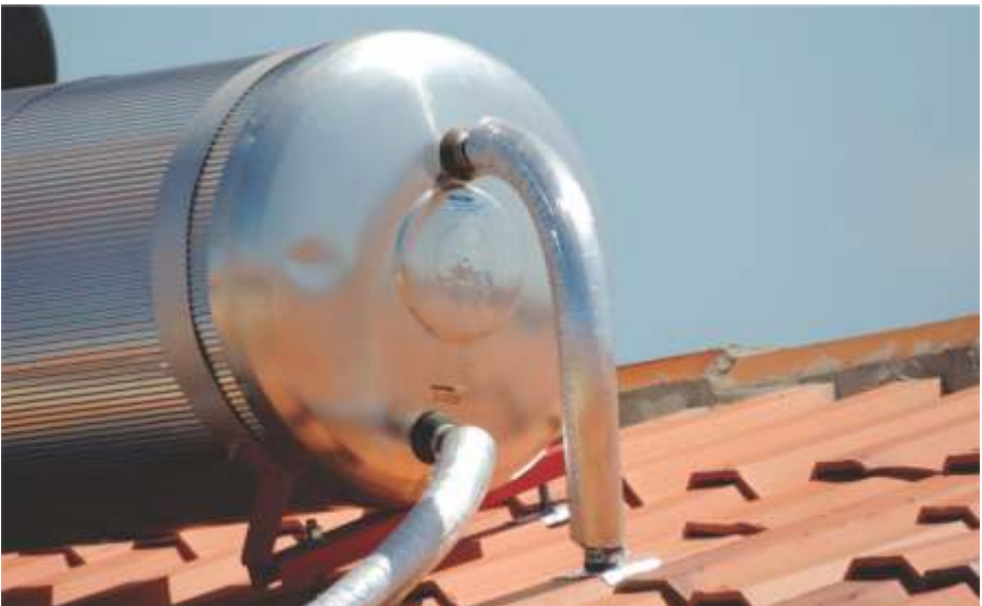
Tubos de interligação com isolamento térmico com proteção de folha de alumínio
