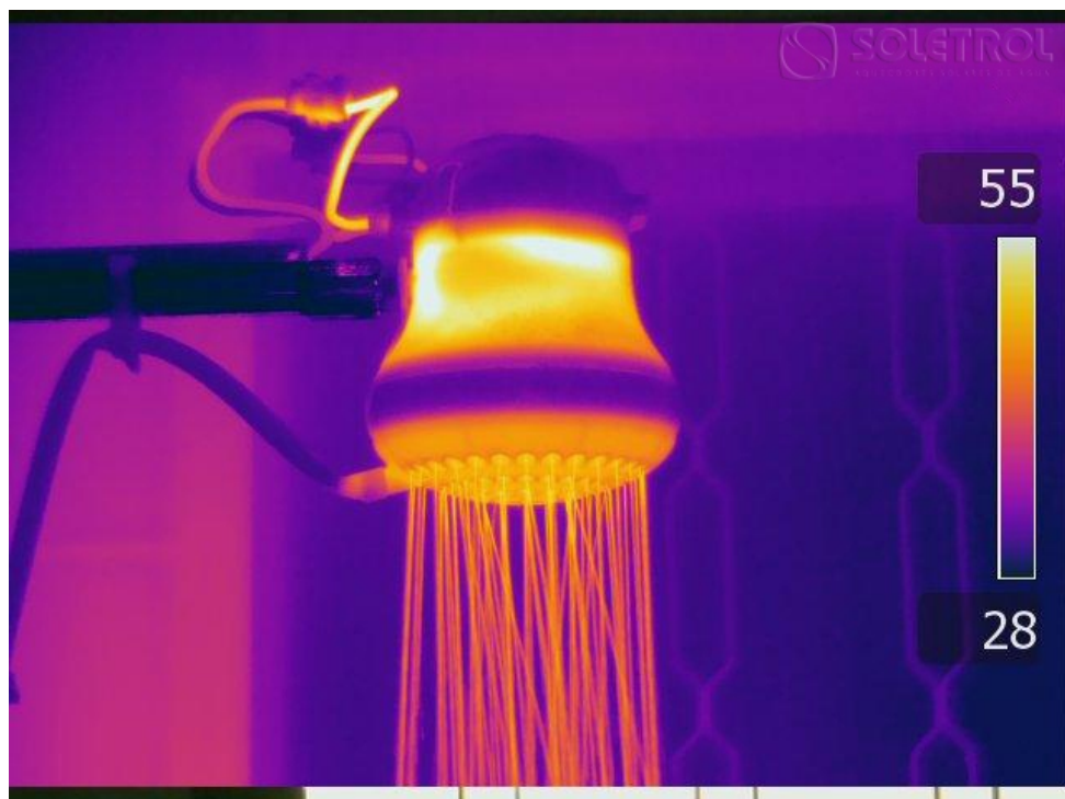
Foto 108 - Imagem infravermelha de chuveiro com mal contato no conector
