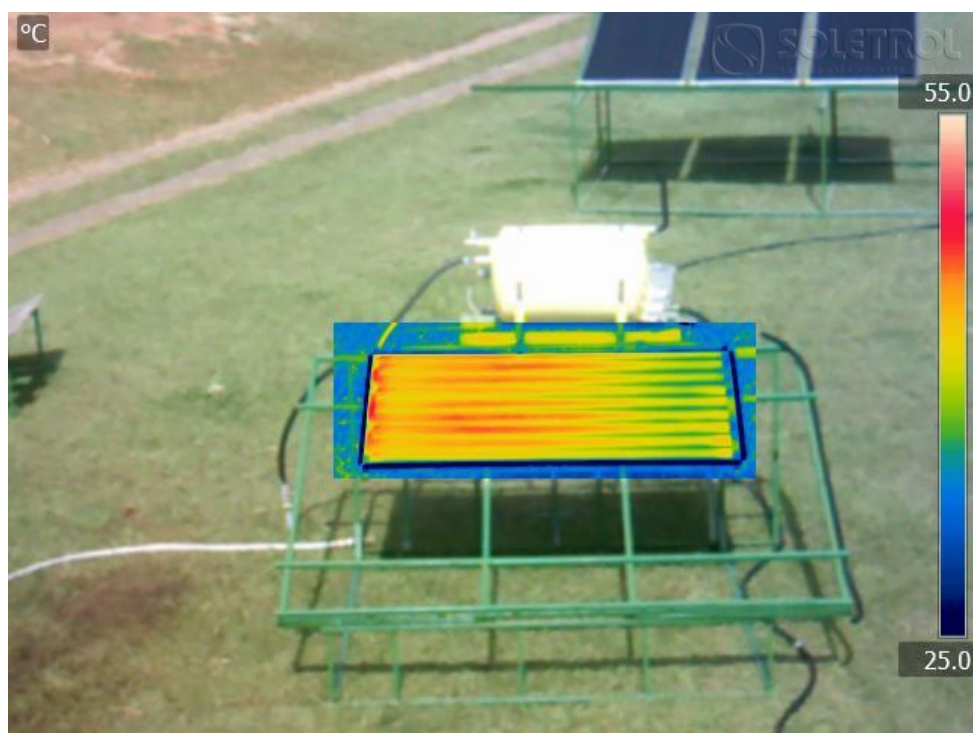
Foto 52 - Imagem infravermelha de coletor instalado invertido e funcionando em termossifão
