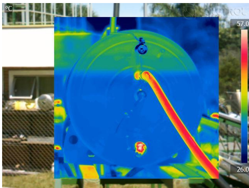
Foto 22 - Imagem infravermelha do reservatório com 20 minutos de funcionamento
