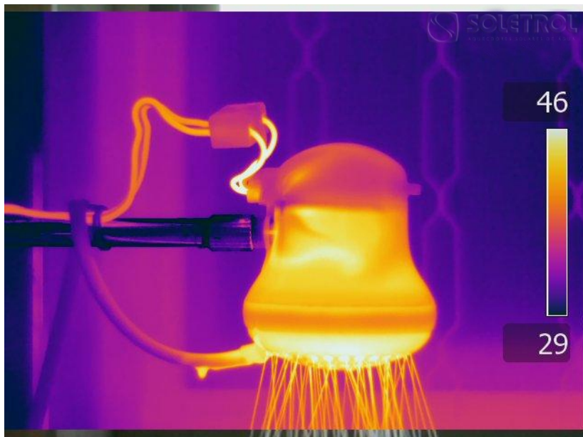
Foto 109 - - Imagem infravermelha de chuveiro com mal contato no conector
