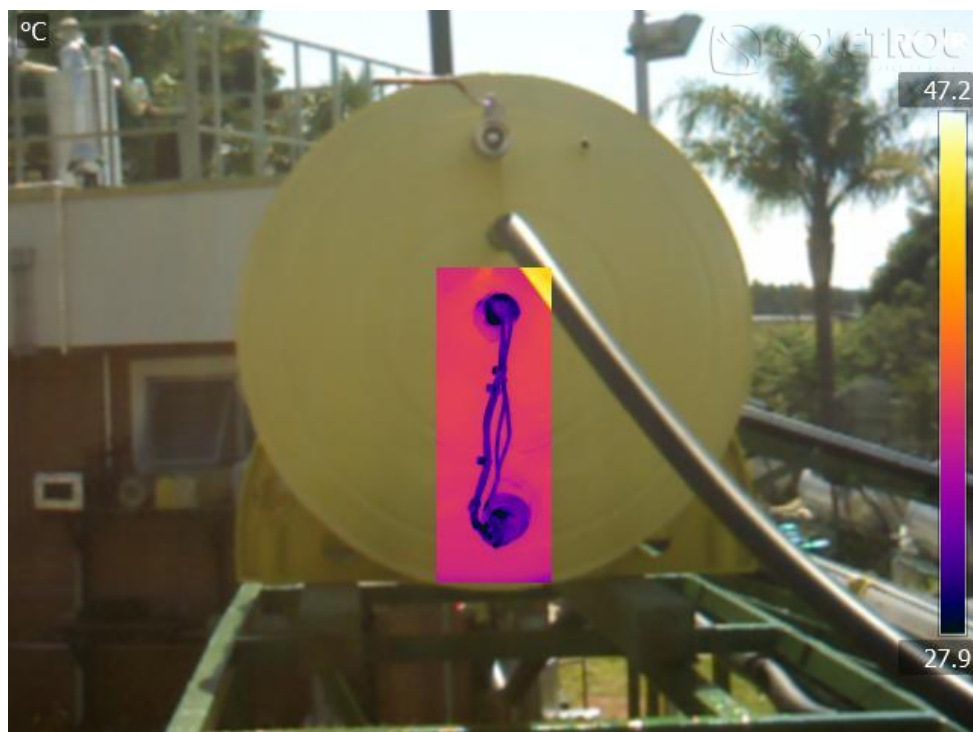
Foto 42 - Imagem infravermelha da resistência elétrica no reservatório térmico
