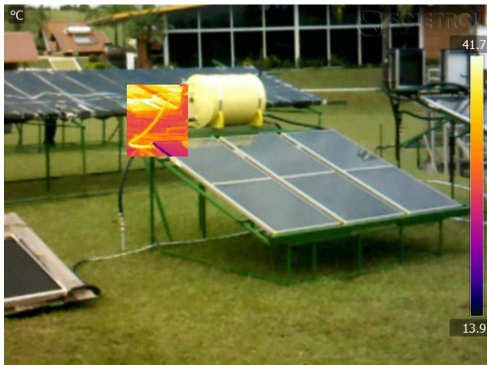
Foto 20 - Reservatório operando em sistema termosifão para demonstração de estratificação
