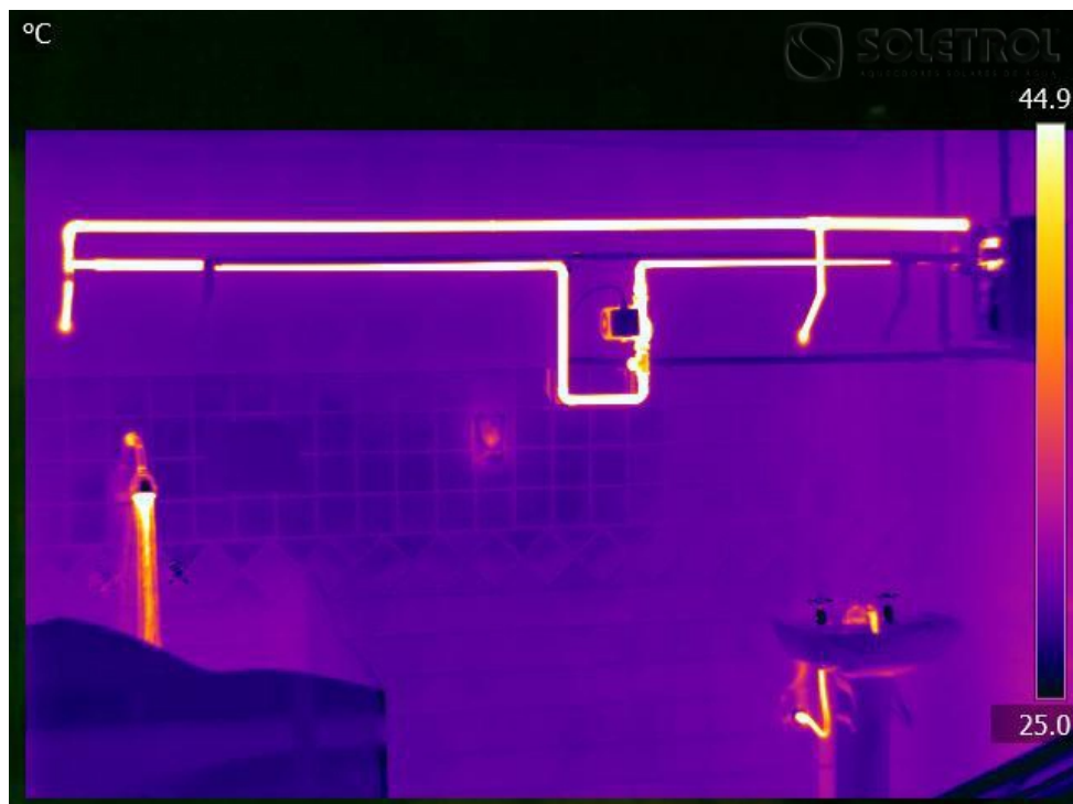
Foto 102 - Imagem infravermelha de anel de recirculação de barrilete em operação
