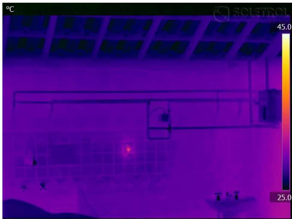
Foto 101 - Imagem infravermelha de anel de recirculação de barrilete sem circulação
